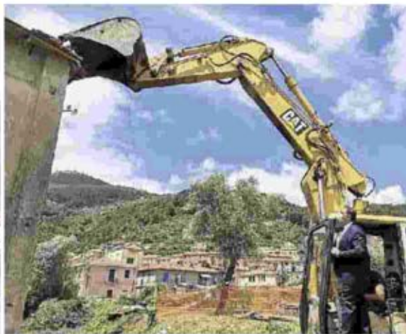
Giovanni Toti sulla ruspa che abbatte una palazzina alla Grazie
